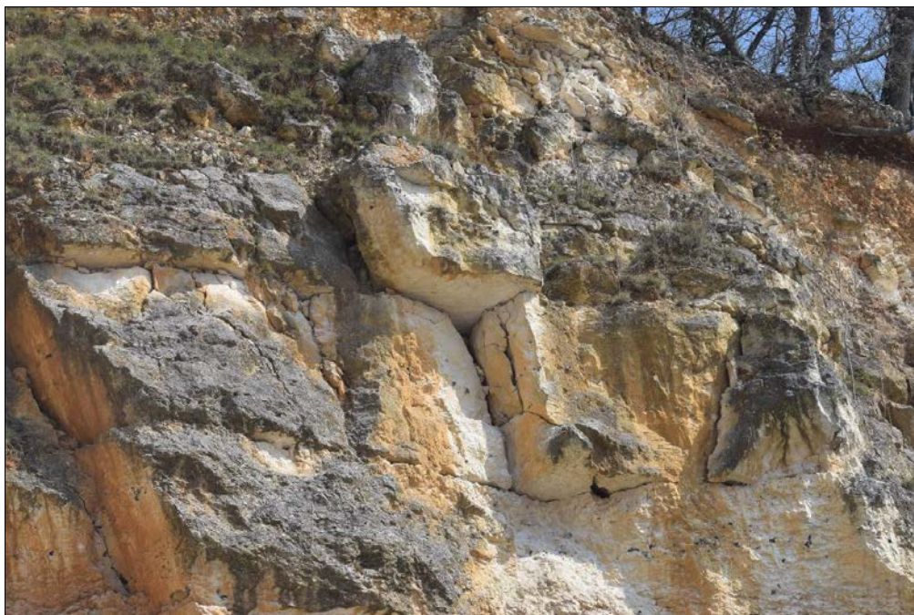
Source: BRGM/RP-69415-FR - falaises à Vernon
